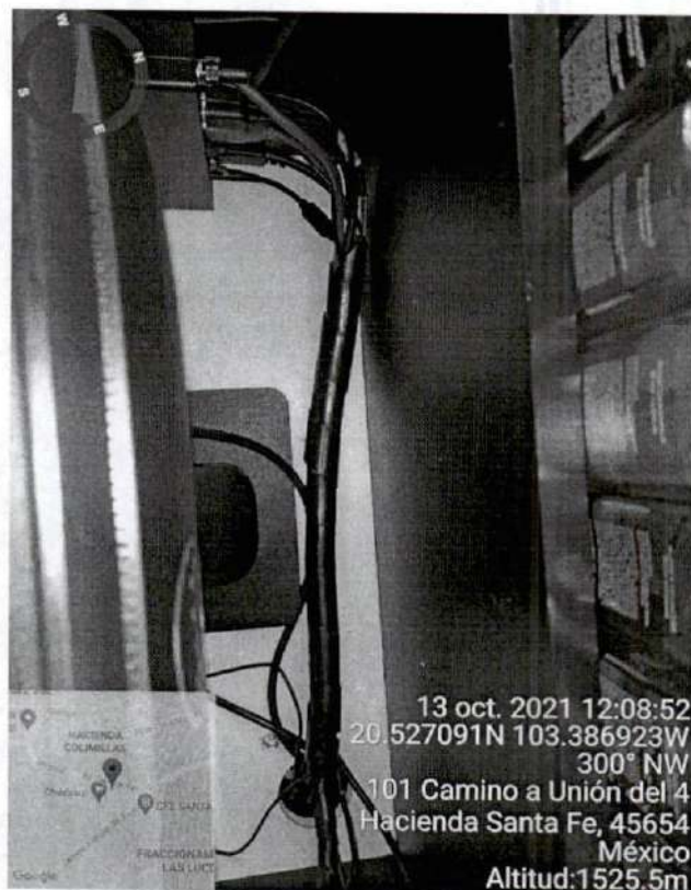
Ilustración 20. Peinado de cables.
